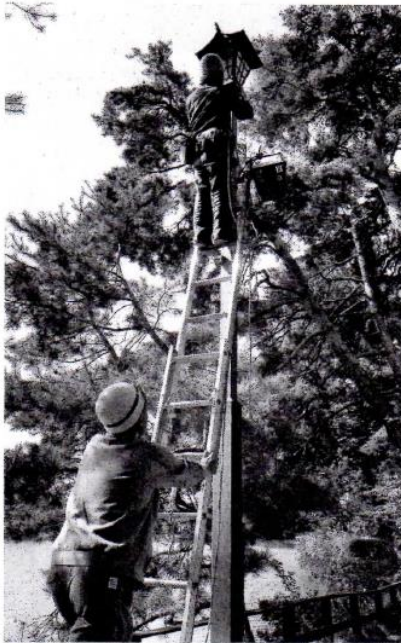
安全に電気を使用できるように、配線診断や灯具の点検などを行った
